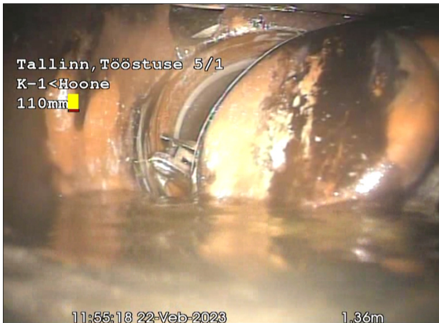
Pilt: Hoone_K-1_1_2_A.jpg 1,36m, Deformatsioon Kl. 11 , B Horisontaalne
